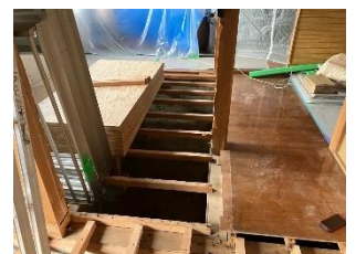
床張替の場合、床がなくて危険な期間があります
